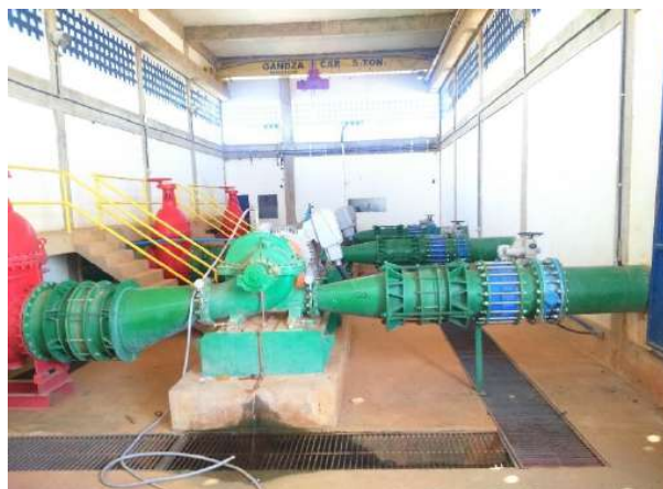
Figura 20 - (EEAB-2A) - Detalhe do Barrilete
