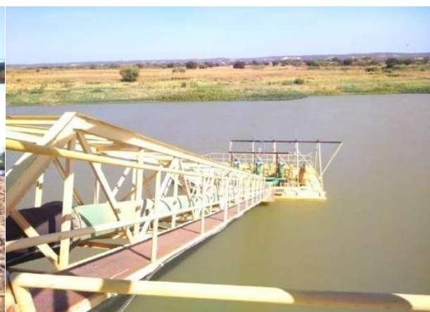
Figura 18 - Captação da SAA do Feijão, detalhe do barrilete
