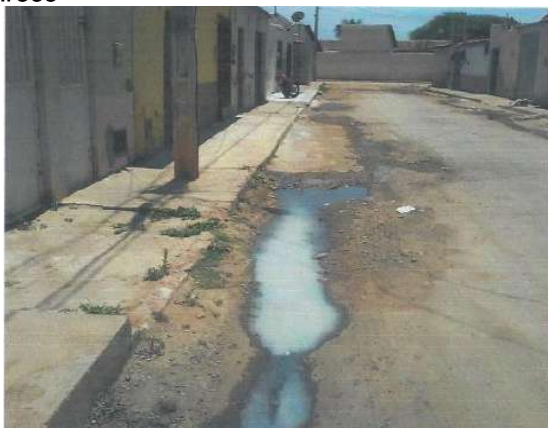
Figura 36 - Escoamento de esgotos a céu aberto na rua B - Loteamento Paulo Freire em Irecê
