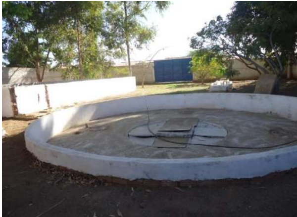
Figura 44 - ETE Novo Horizonte
