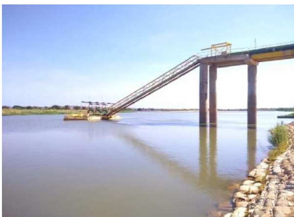
Figura 19 - Captação da SAA do Feijão
